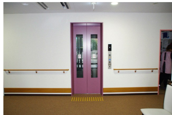
エレベーター
